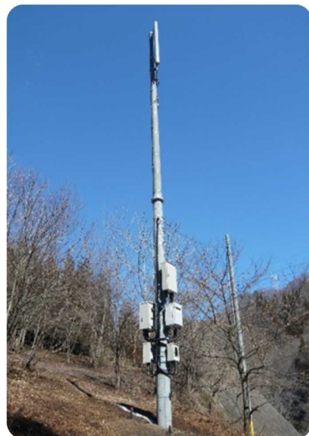
携帯電話等基地局施設(黒川)
